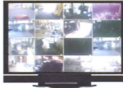
Kontrol Merkezi / Control Center
